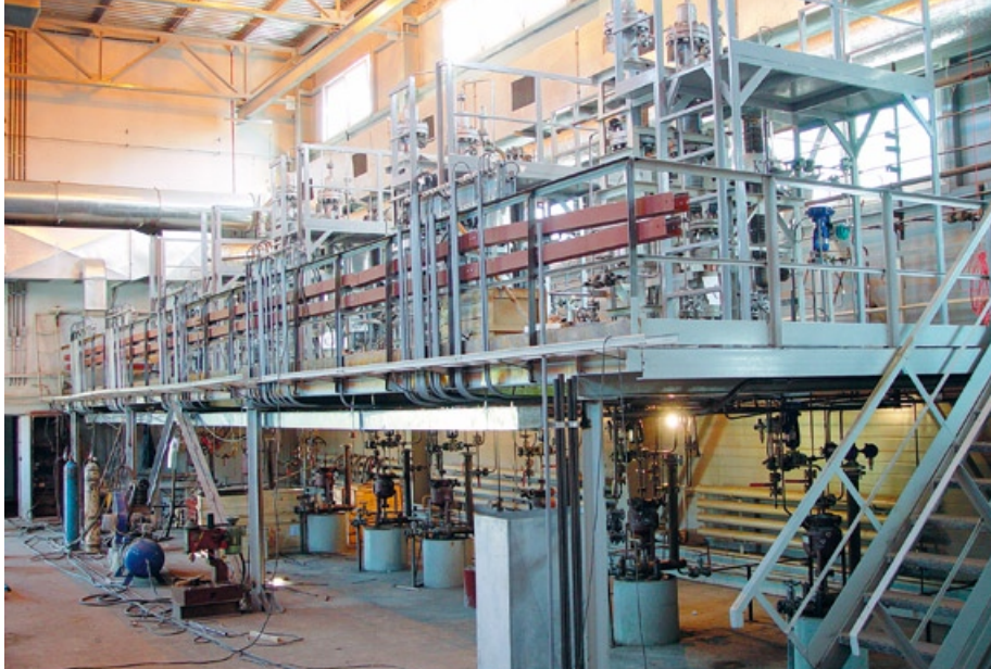
Стендовые установки для отработки технологии производства СЖТ
