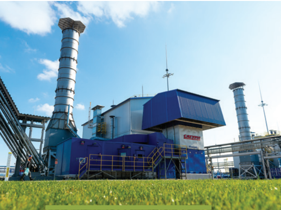
~ ГПА 25, КС «Шахтинская»
