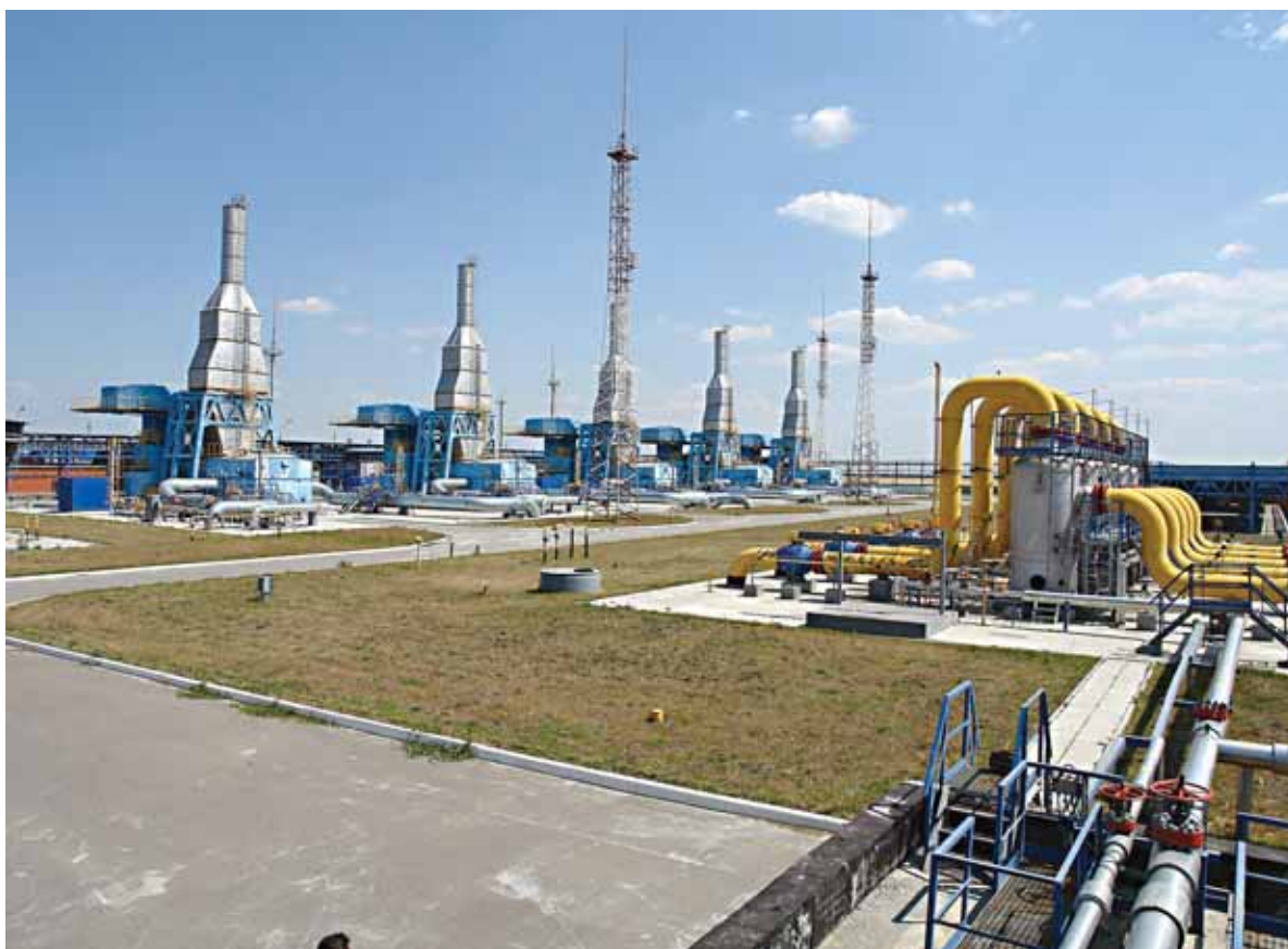
Нововетровская компрессорная станция.
